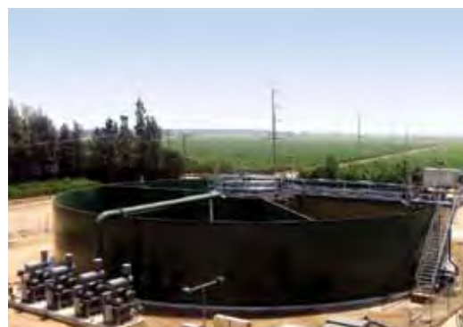
Un sistema OXIGEST® instalado en California.
